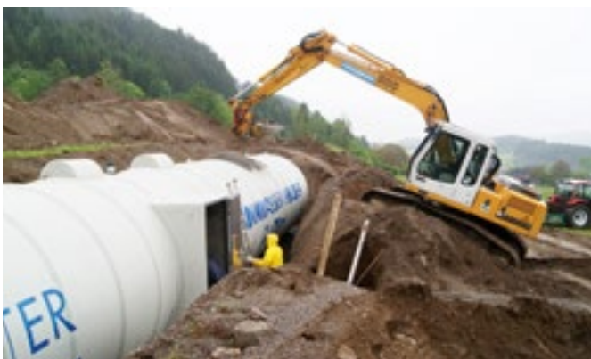
150.000 L Speicher mit mittiger Schieberkammer
